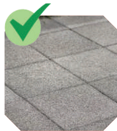
placas de concreto sem quinas chanfradas
